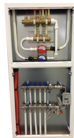
Gulvvarme og tappevann er adskilt, unngår lekkasje på GV automatikk etc.
